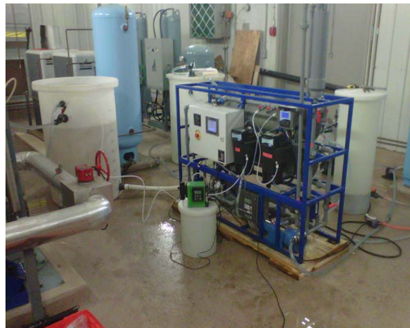
L'installation du système pilote de membrane FYNE dans l'ancienne chambre à ozonation à WTP
